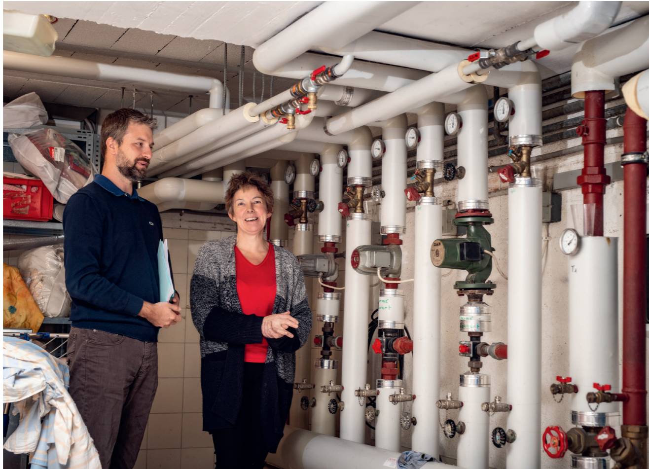
Peik-Berater Mark Iten erklärt Hotel-Pächterin Monika Gigandet das Optimierungspotenzial der Heizungsanlage
